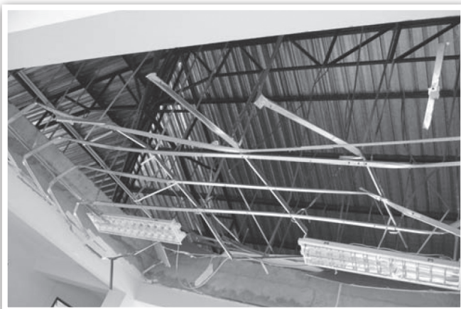
รูปที่ 9 สภาพผ้าเพดานบริเวณช่องบันไดชั้น 3 ที่พังเสียหายอย่างหนัก
